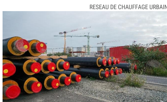
RESEAU DE CHAUFFAGE URBAIN © A. Loubry. Rennes Ville et Métropole.
